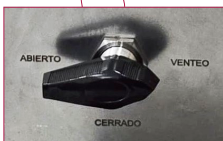
Válvulas de operación
